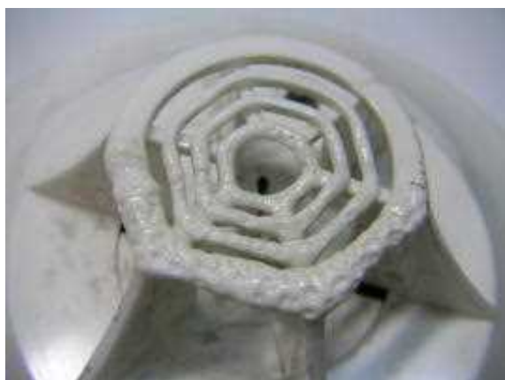
定温式スポット型感知器の不適切な点検による樹脂、保護カバーの溶け・変形
