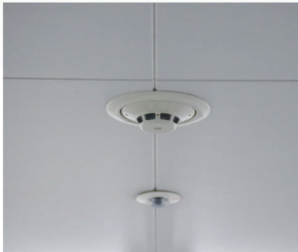
写真2：現地に設置されている煙感知器とスプリンクラーヘッド
